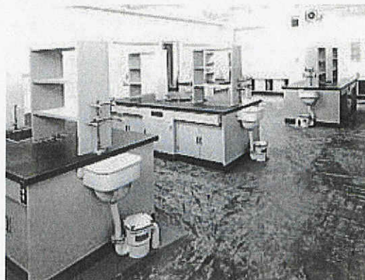
中央大型実験台(フレームタイプ)
